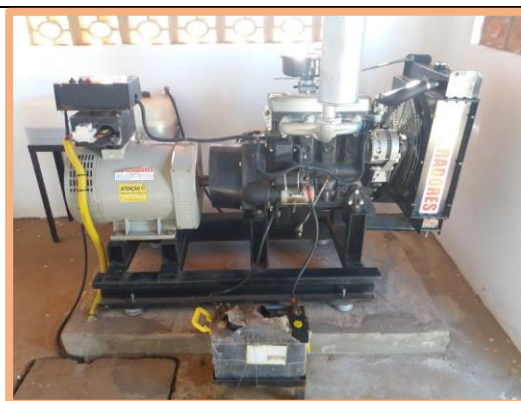
Gerador de Emergência (GE)
