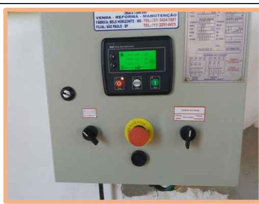
Quadro de Comando do GE
