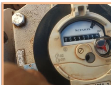
Macromedidor com tampa solta
