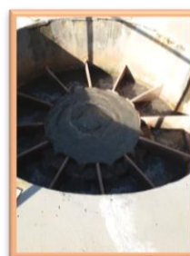
Entrada do Reator UASB
