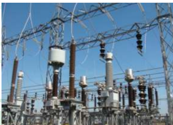
Subestação Chapadão do Sul
