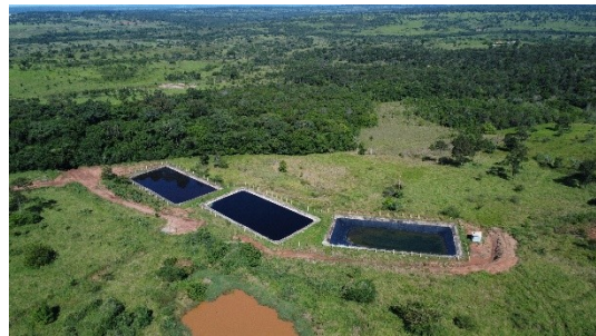
Figura 8 - Vista das lagoas de tratamento.
