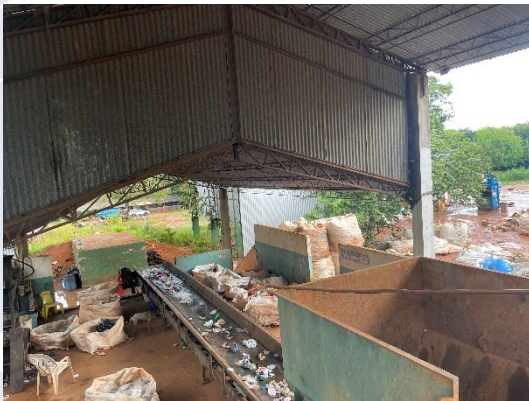
Figura 25 - Detalhe da esteira de triagem.
