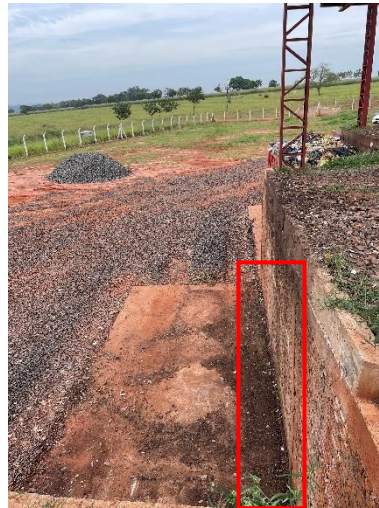
Figura 7 – Piso impermeabilizado no local de disposição dos contêineres, e canaleta de drenagem obstruída.
