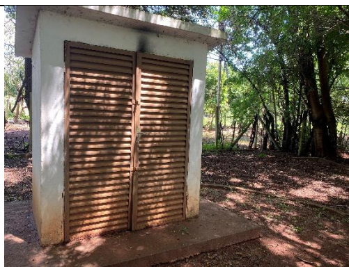
Figura 121 – Abrigo do quadro de comando elétrico.
