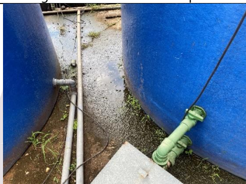
Figura 102 – Infiltração nas bases.
