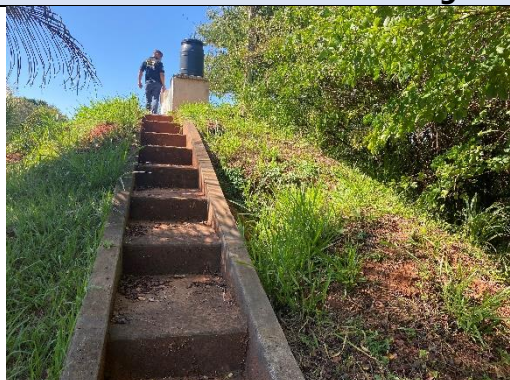
Figura 80 – Ausência de guarda-corpo no Preliminar.
