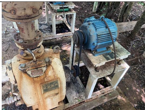
Figura 119 – Ausência de proteção das correias.
