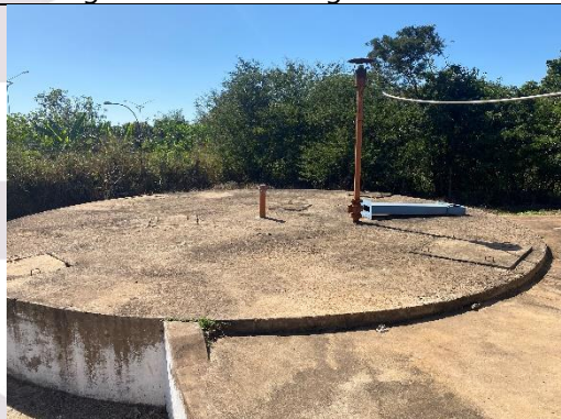
Figura 94 – Vista geral do reator UASB.
