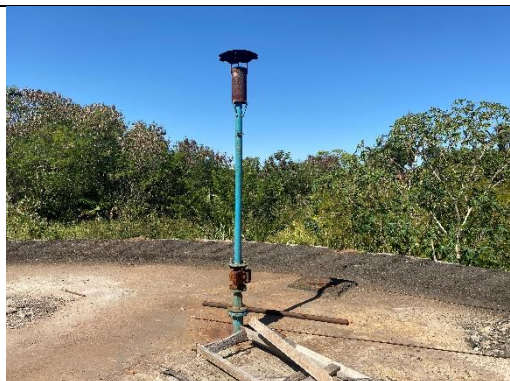
Figura 86 – Queimador de biogás inoperante.
