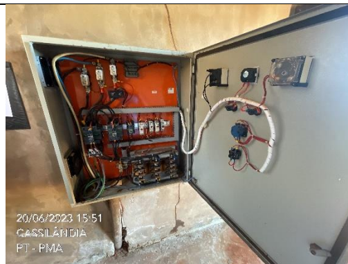
Figura 19 – Quadro de comando elétrico.
