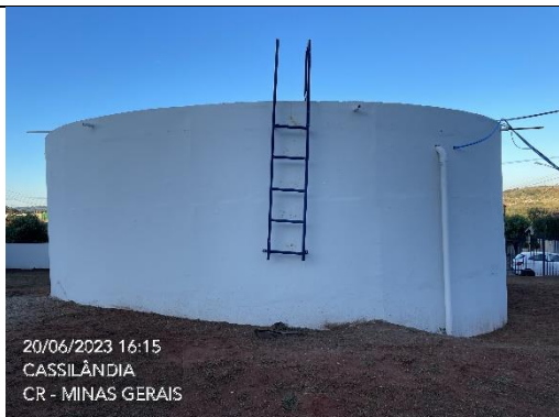
Figura 134 – Reservatório CR-Minas Gerais.
