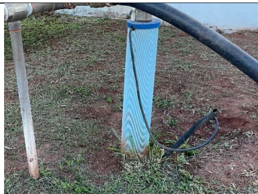
Figura 33 – Laje de proteção do poço ausente.
