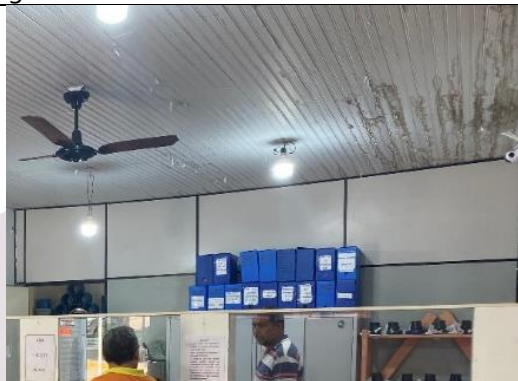
Figura 6 – Detalhe do forro danificado.
