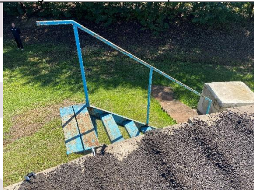
Figura 84 – Guarda-corpo da escada do reator avariado.
