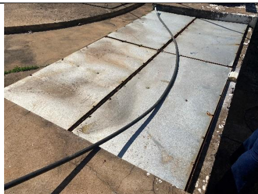
Figura 93 – Tampas metálicas sem alça.
