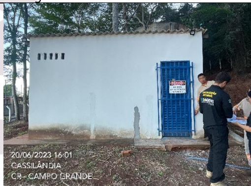
Figura 28 – Abrigo do quadro de comando e Unidade de Cloração de Água Tratada.
