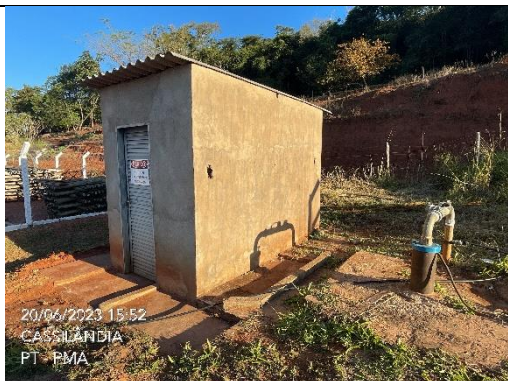
Figura 18 – Abrigo do quadro de comando.
