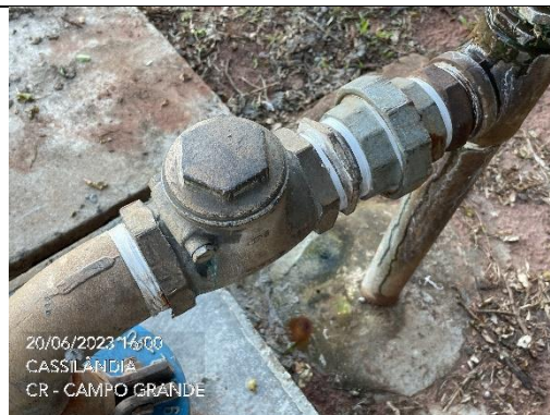
Figura 25 – Ausência de macromedidor.
