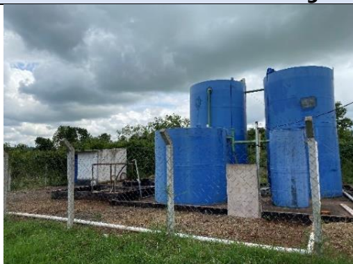
Figura 100 – ETE Vale do Aporé.
