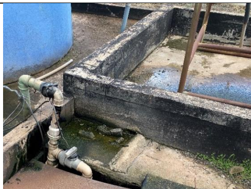
Figura 106 – Área com infiltração.
