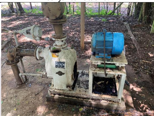
Figura 120 – Detalhe de moto bomba sem o conjunto rotativo.
