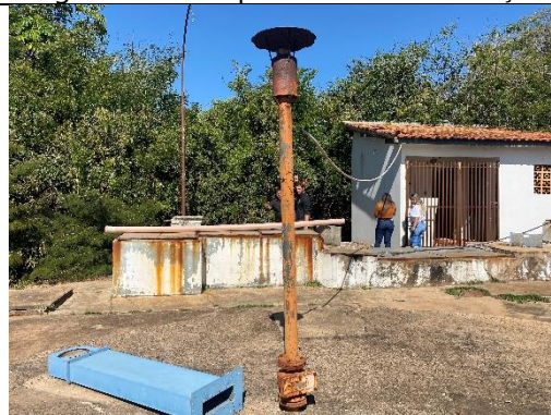
Figura 95 – Queimador de biogás inoperante.
