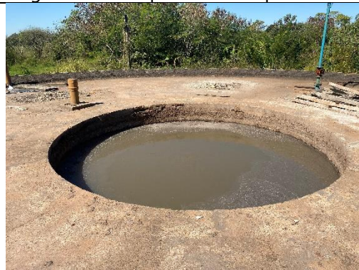
Figura 85 – Vertedouros centrais obstruídos.
