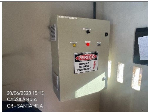
Figura 135 – Quadro de Comando CR-Santa Rita.
