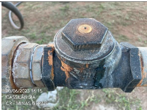
Figura 32 – Vazamento de válvula do poço.
