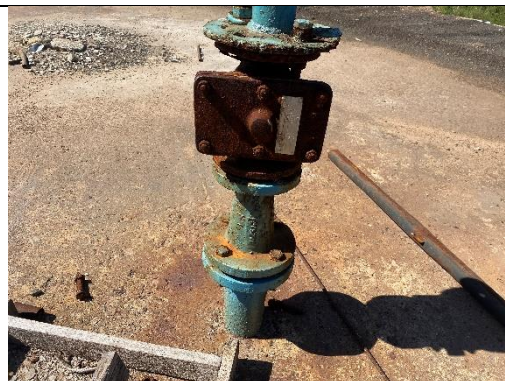
Figura 87 – Válvula anti-chamas oxidada.
