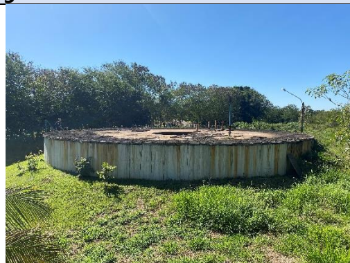
Figura 81 – Ausência de guarda-corpo no reator UASB.
