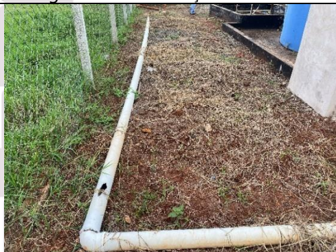
Figura 104 – Tubulação exposta e avariada.
