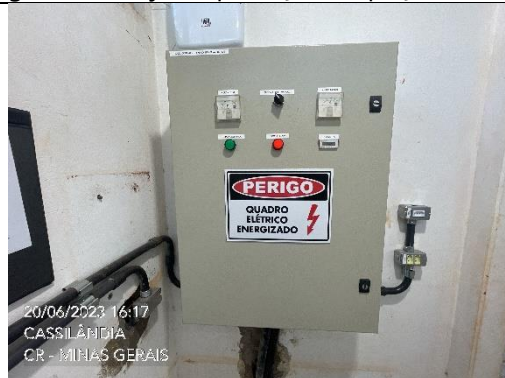
Figura 35 – Quadro de comando elétrico.
