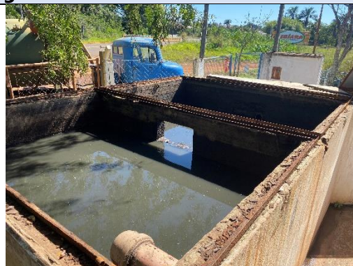
Figura 91 – Tanque de recebimento de autofossa.
