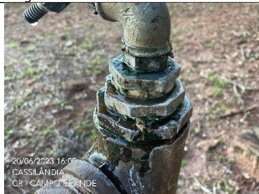
Figura 27 – Detalhe de vazamento.
