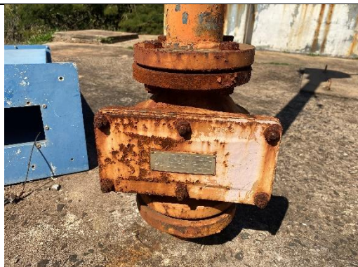
Figura 96 – Válvula anti-chamas oxidada.
