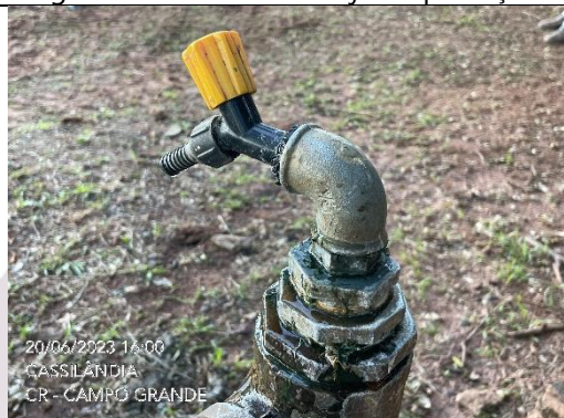
Figura 26 – Vazamento em torneira.
